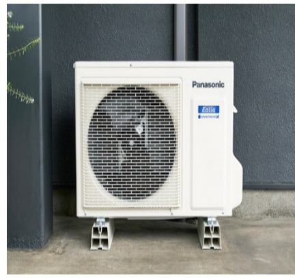
エアコン (フロン回収済み)
