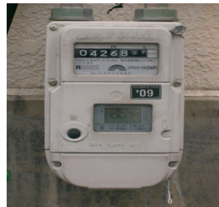
ガスメーター
