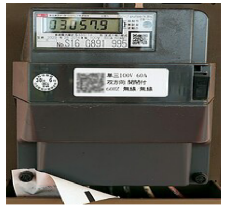
スマートメーター
